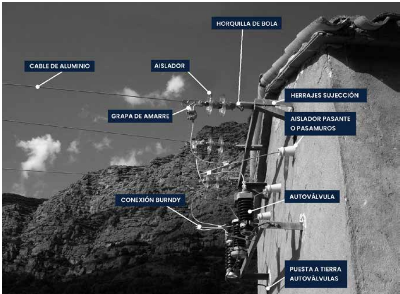
Ilustración 1 Casetas de transformación antigua [5]
