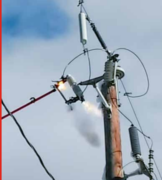
Ilustración 6 Arco eléctrico en operación de seccionador fusible. [5]
