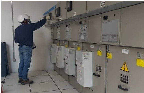
▲ Figura 1: Inicio de puesta en marcha de las celdas de media tensión ICET.
